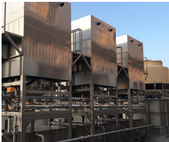
ด้านนอกของอุปกรณ์บำบัดน้ำเสียในโรงงานเคมี(รุ่นขนาดใหญ่)
